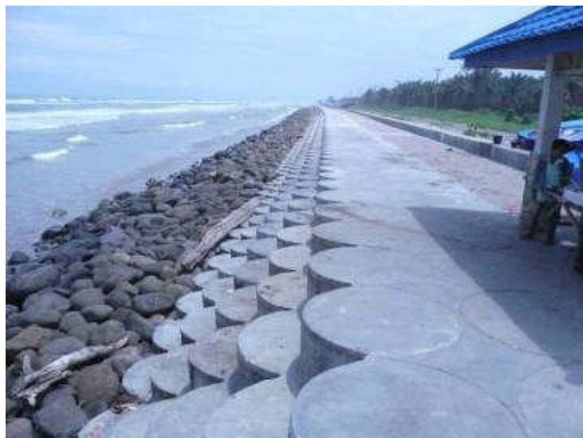
Gambar 7.2 - Contoh tembok laut di Pantai Panjang Bengkulu
